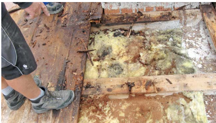
Feuchteschaden am Flachdach.
